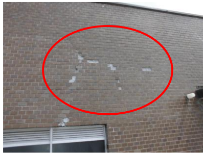
老朽建物外壁（築44年）
