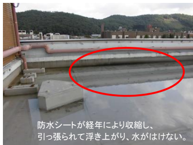
老朽建物防水（築44年）
