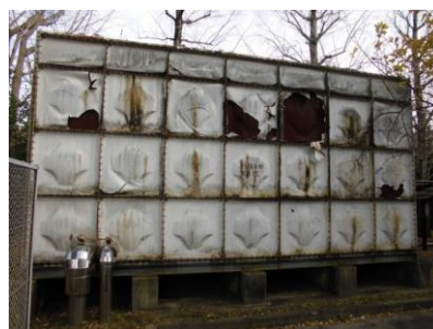
老朽貯水槽（築50年）
