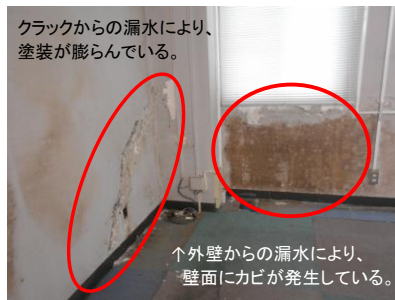
老朽建物外壁（築50年）
