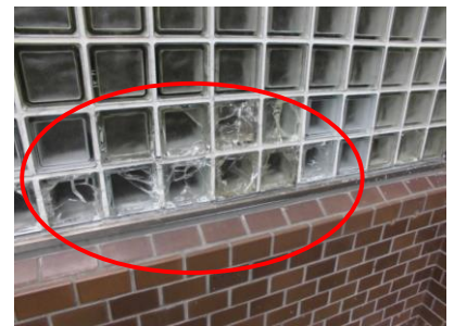
老朽建物外壁（築49年）
