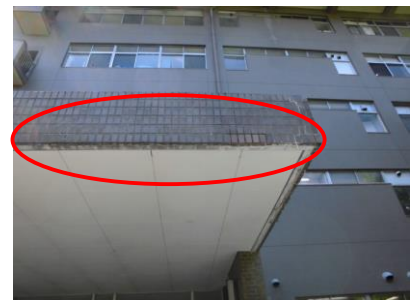
老朽建物玄関庇（築50年）
